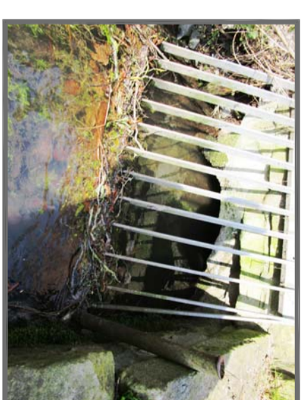
Grabenslauf DN 1000 mit Rechen
